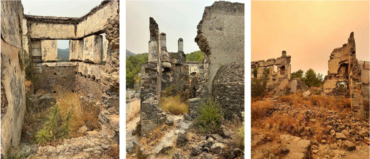
Görsel 3. Kayaköy’de koruyucu yapı bileşenlerinin kaybı: çatısız konut hacmi (sol), açıkta kalan duvar üstü (orta), döşeme kaybıyla dış ortama açılan iç mekân (sağ). Kaynak: Yazar arşivi, 2026.
